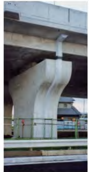
◆ 圏央自動車道 R 橋脚取付台形 排水管
